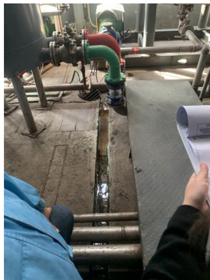
提纯车间冲洗水收集沟渠
