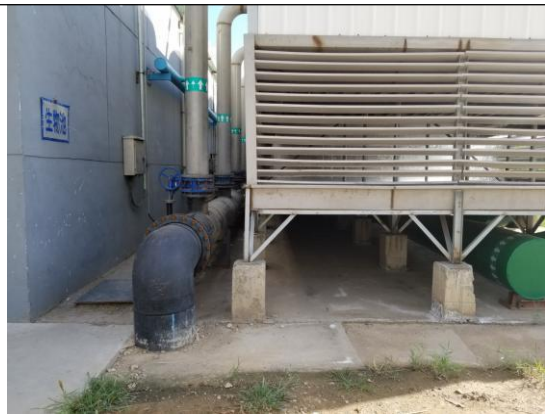
热风炉二级池+生物池+冲洗池
