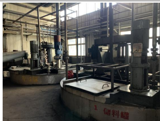
造粒车间配料罐
