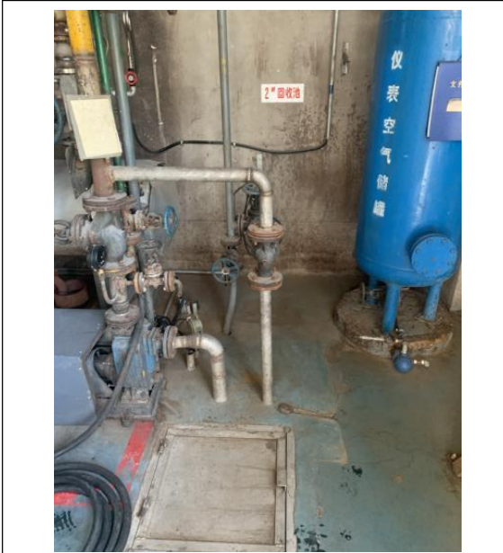
发酵车间 2#回收池
