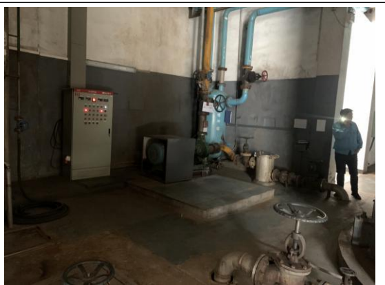
发酵车间 3#回收池
