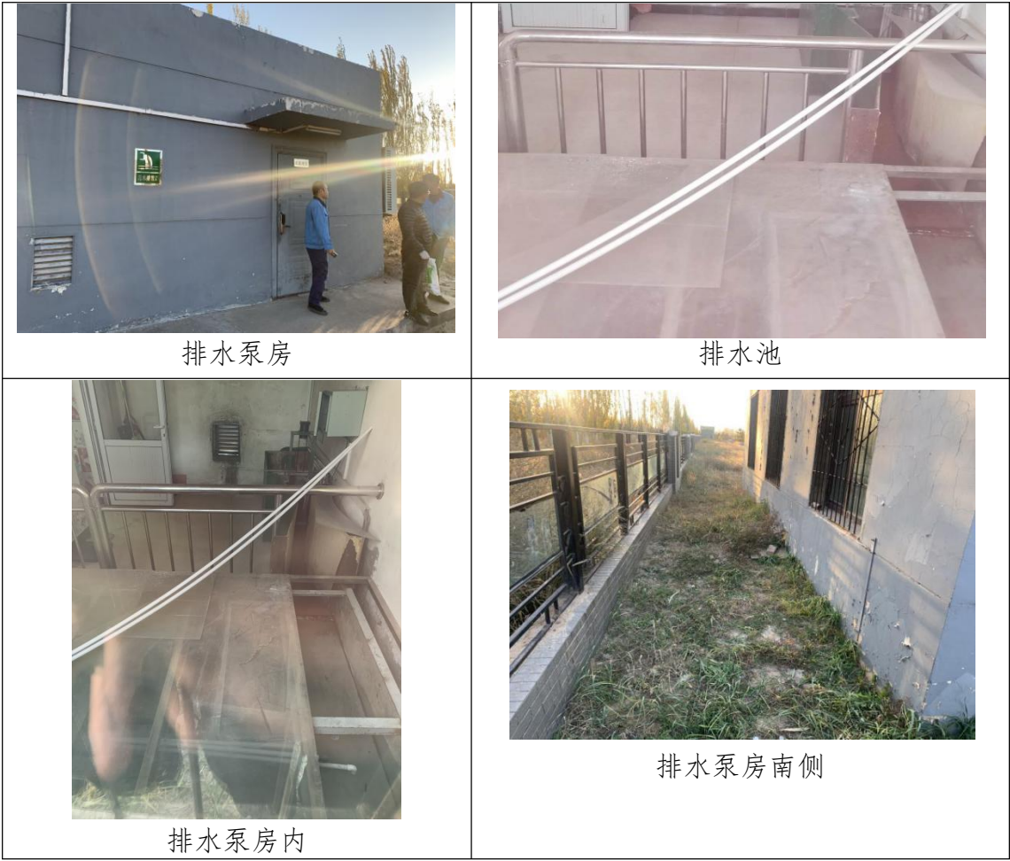
图 5.3-6 排水泵房情况
