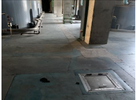
发酵车间回收池管道（2）
