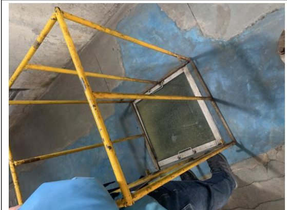
发酵车间回收池管道（1）
