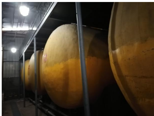
液体库氨水罐
