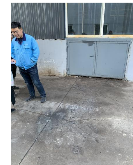
配料罐加料口裂缝及污染痕迹
